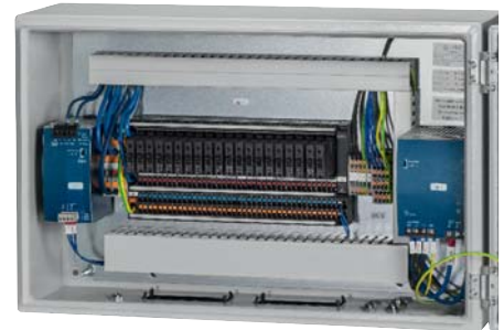
Dezentraler Stromverteiler bestückt mit therm.-magn. Schutzschaltern Typ 2210
